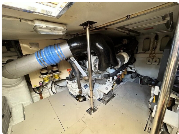
Az 62 Sala macchine.1
