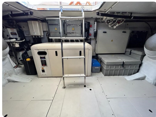
Az 62 Sala macchine - vista generatore
